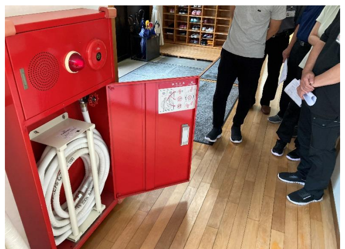
<消火設備の確認の様子>
